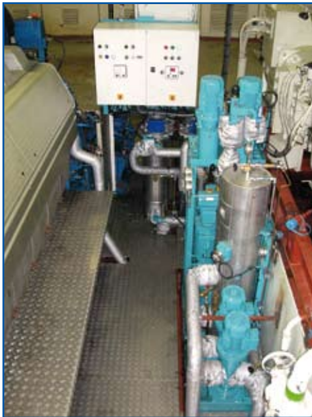
Via het HFO booster systeem gaat de brandstof naar de hoofdmotor.
