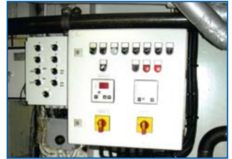
Heetwater bedieningspaneel, inclusief afstandsbedieningen heetwater en bunkerafsluiters zware olie.
